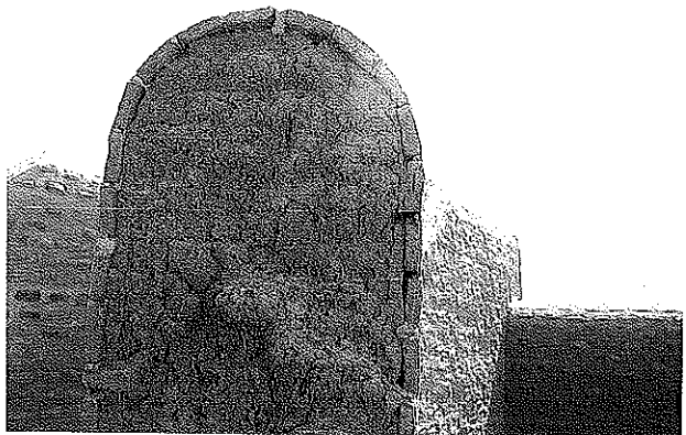
Photo 51 La structure des murs: briques de banco et revêtement en briques cuites par les potières du SOFARA.
