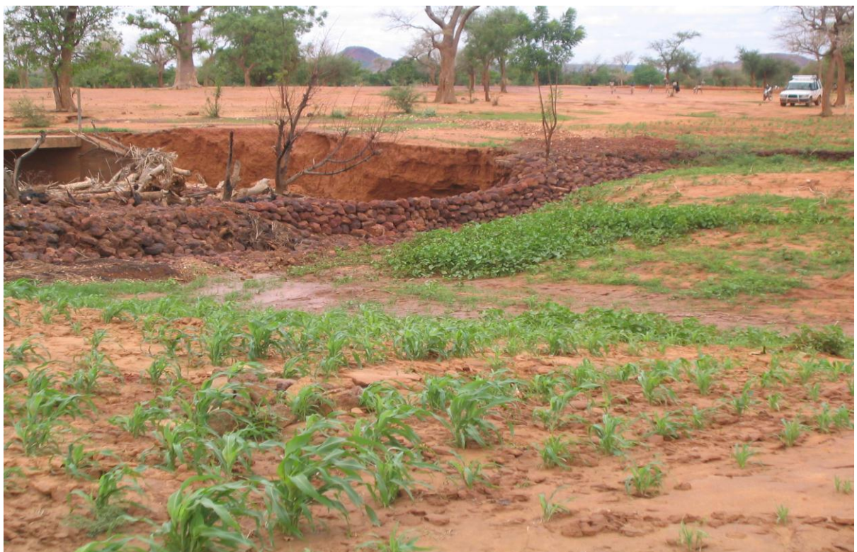
Situation après aménagement : les sédimentations ont permis de récupérer et exploiter nouvellement la terre, pour la première fois depuis 20 ans
