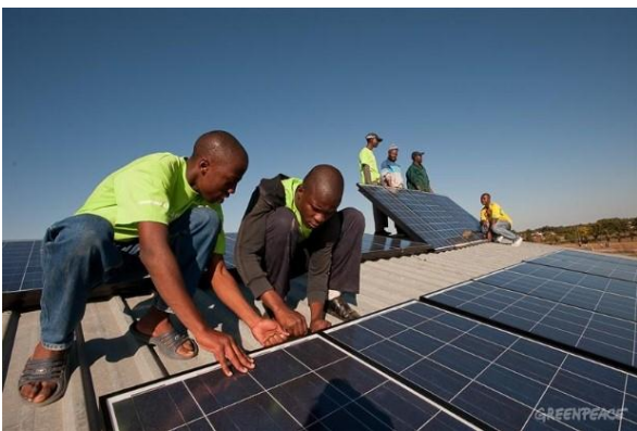
Figure 12 Mesure d'atténuation : installation des panneaux solaires pour une production d'énergie sans émissions de gaz à effet de serre
